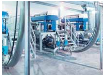
Насосы seerex BT1 10-24 . Продукт: обезвоженный шлам из центрифуги с примерно 20% сухого остатка.
