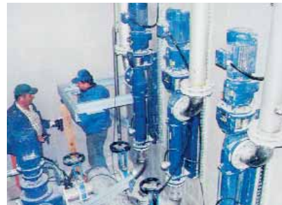
Насосы BN 35-6L и мацераторы seerex I 110 . Продукт: первичный шлам к септической камере. Особенность: насосы в связи с тесными условиями в насосном прямке смонтированы вертикально на стене.
