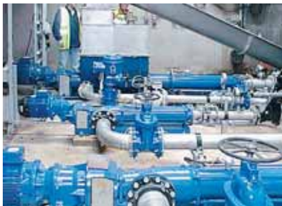
Насосы seerex BT 70-12 и BN 52-6L . Продукт: импортированный обезвоженный шлам с 30% сухого остатка и первичный шлам примерно с 1 - 2% сухого остатка. Особенность: обратное перемешивание импортированного шлама с первичным шлагом примерно до 6% сухого остатка и дальнейшая транспортировка к септической камере. Первичный шлам подается сбоку в загрузочную воронку.
